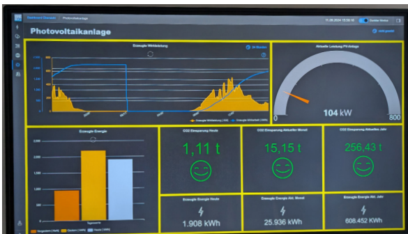
Das Solardach der ARA Ludesch deckt den Strombedarf zu fast 80 Prozent. Etwaige Überproduktionen werden ins heimische Stromnetz eingespeist.
